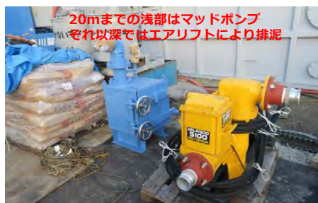
マッドポンプとストーンキャッチャー
