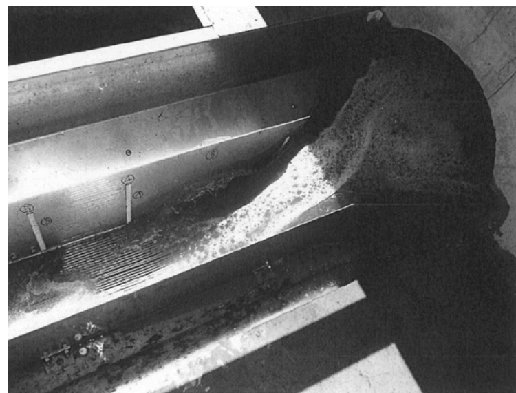
流入量81.8L/sの時の汚水の通過状況 (スクリーンの途中で全量落水)
