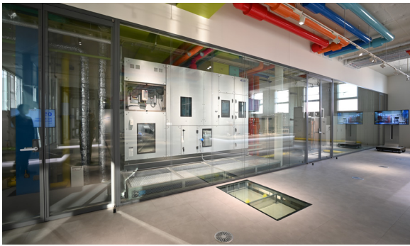
写真-4 ショールーム内ガラス張り機械室
