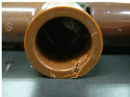
写真 2 クレオソートを部分塗布した CPVC 継手
