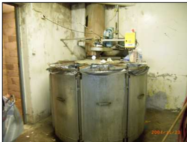
集合住宅の地下ゴミ箱 (中庭から投入されたゴミがパイプを通し落ちて来る)
