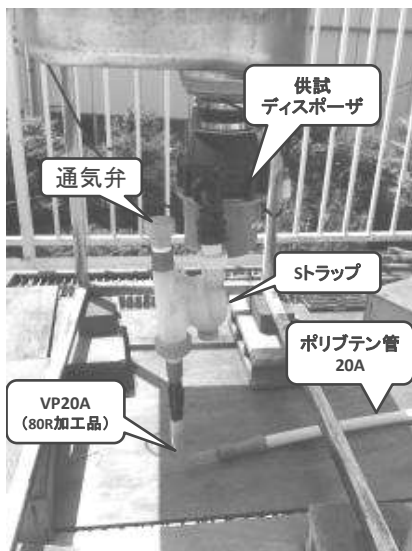
図-4 キッチン廻り接続状況
