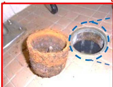
わんが腐食した鋳物製床排水トラップ
