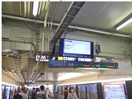
▼地下通路天井に沿って鳥居配管 真空管路、真空チューブ、電気配管
